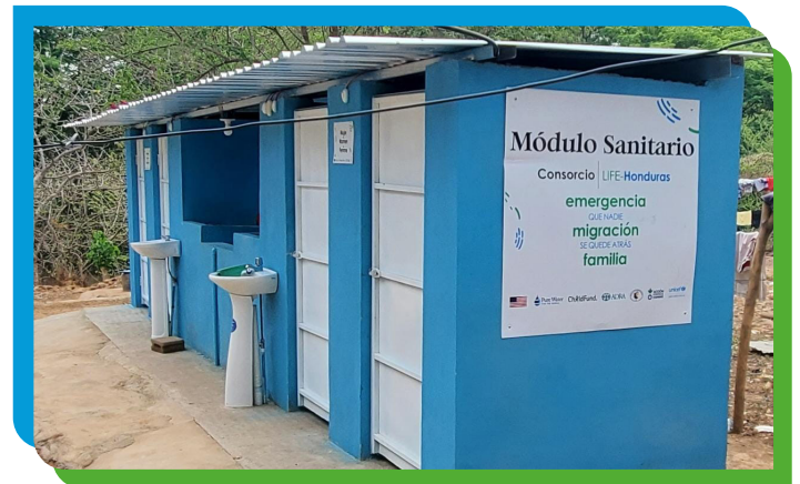
Instalaciones de módulos sanitarios para personas migrantes que transitan por Honduras. (Guasaule, Choluteca)
